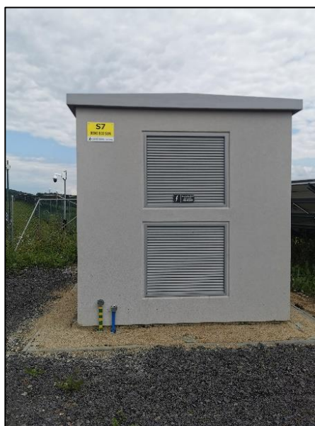
Rys. 10 Przykładowa stacja transformatorowa (Źródło: Materiały własne)
