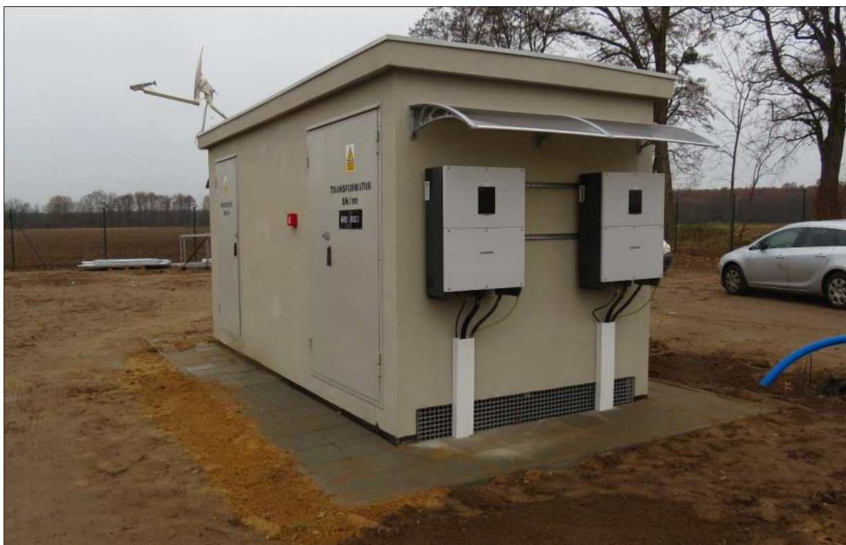
Rys. 9 Falowniki zainstalowane na stacji transformatorowej SN (Źródło: Materiały własne)
