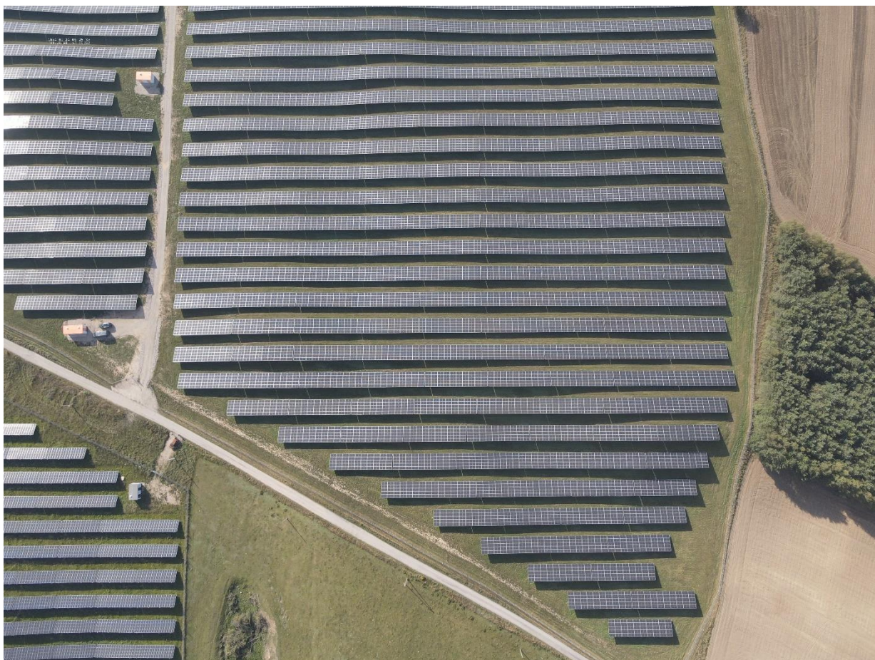
Rys. 14 Elektrownia fotowoltaiczna Kościerzyna: układ dróg dojazdowych, paneli fotowoltaicznych oraz stacji transformatorowych na terenie inwestycji (Źródło: materiały własne)
